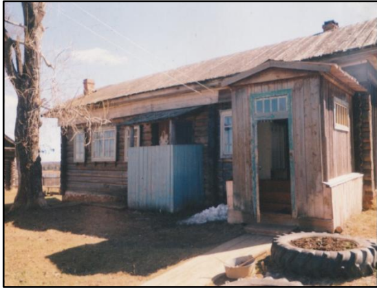
Так выглядит сегодня это здание, где с 1940 по 1949 гг. размещалась Аксеновская изба-читальня
